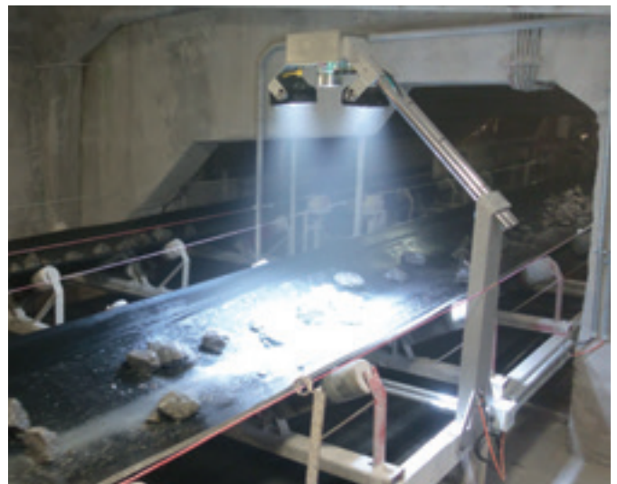
HAVER SOLO M4 bei der Materialanalyse direkt über dem Förderband.
